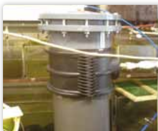
Směšovací zařízení vody se vzduchem pod tlakem – Mendelova univerzita v Brně.
