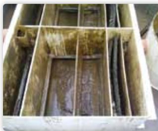
Mechanická filtrace pro přívod vody do odchovny pstruhů.
