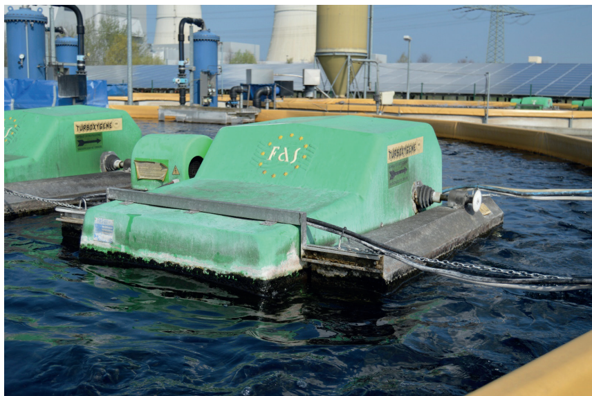
Obr. 14. Oxygenační zařízení k dodatkovému zlepšení kyslíkového režimu v nádrži. Kyslík je zde rozpouštěn mícháním vody lopatkami v O_2 atmosféře vytvořené ve „zvonu“ (Foto: J. Regenda).
