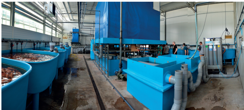
Obr. 17. In-door RAS systém s chovem tlamouna nilského ( Oreochromis niloticus ) a keříčkovce červenolemého ( Clarias gariepinus ) na akvaponické farmě Blün GmbH, Vídeň, Rakousko. V levé části laminátové nádrže s rybami, uprostřed v popředí sedimentační nádrže pro mechanické předčištění vody; uprostřed v pozadí skrápěný biofiltr (Foto: J. Regenda).
