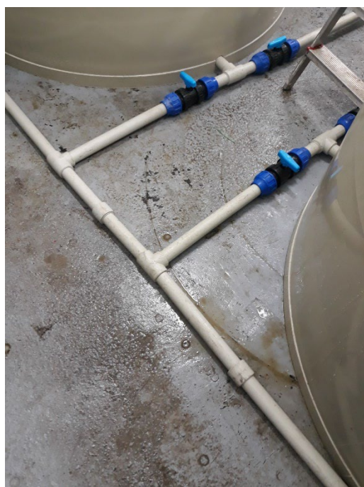
Obr. 31. Instalované odkalovací ventily u dnových výpustí umožňují kompletní vypuštění nádrží.
